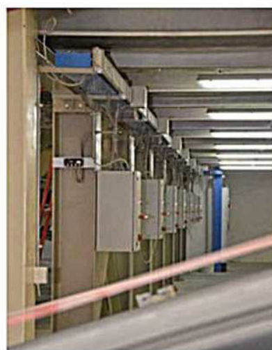
Panoramica dei quadri elettrici distribuiti sotto i silos, per il collegamento degli inverter per i nastri e delle celle di carico in CANopen.
