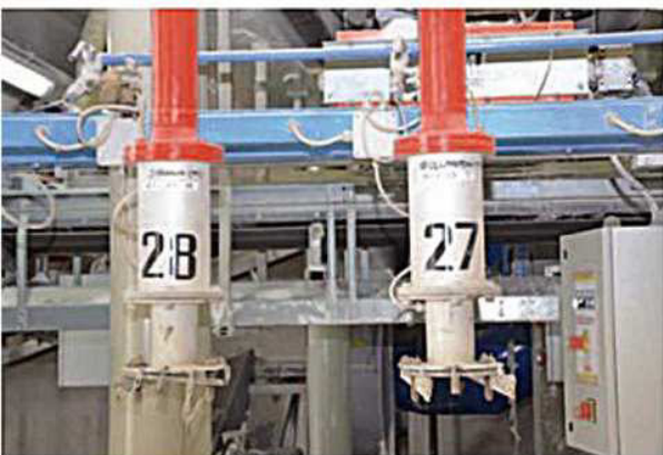
Particolare delle tubazioni di carico a pressione.
